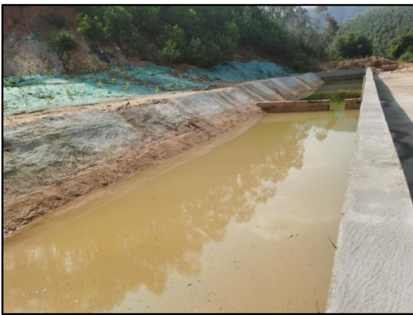
初期雨水沉淀池
